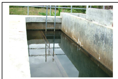
รูปที่ 39 ถังรวมตะกอน
