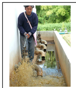
รูปที่ 84 เปิดประตูน้ำระบายตะกอน ข้างถังตกตะกอน(ประตูน้ำหมายเลข 6)
