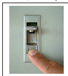
รูปที่ 21 ปุ่มล๊อคฝาตู้ควบคุมเครื่องสูบน้ำ
