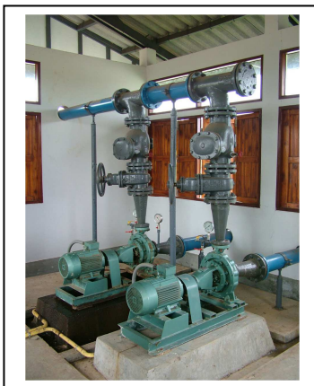
รูปที่ 3 เครื่องสูบน้ำดิบติดตั้งในโรงสูบน้ำ
