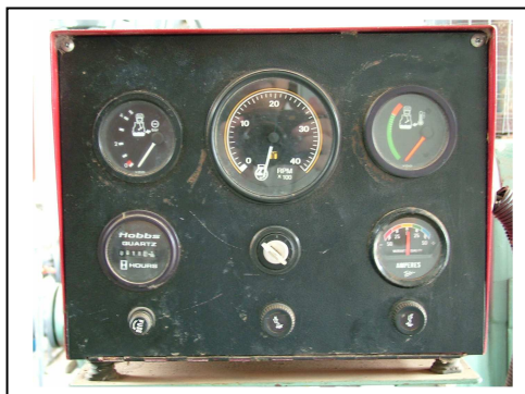
รูปที่ 17 แผงควบคุม เครื่องยนต์ดีเซล
