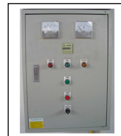
ลักษณะภายนอกตู้ควบคุมเครื่องสูบน้ำแบบหอยโข่ง
