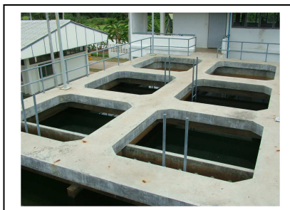
รูปที่ 43 ถังตกตะกอน
