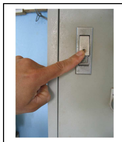
รูปที่ 23 ปุ่มล๊อคฝาตู้ควบคุมเครื่องสูบน้ำดับ
