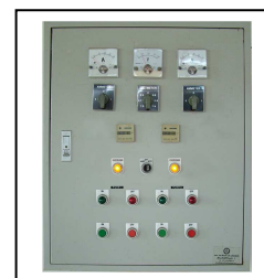
ลักษณะภายนอกตู้ควบคุม เครื่องสูบน้ำแบบหอยโข่ง
