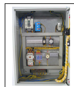
ลักษณะภายในตู้ควบคุมเครื่องสูบน้ำแบบหอยโข่ง
