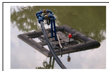
รูปที่ 4 เครื่องสูบน้ำดิบติดตั้งอยู่บนแพลอย
