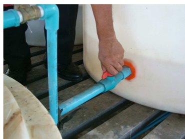
(5) เปิดสารละลายคลอรีนลงในถังจ่ายสารละลายคลอรีน
