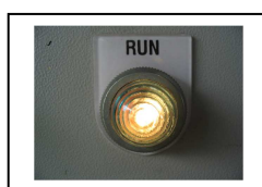
รูปที่ 27 หลอดไฟสีเขียวสว่าง
