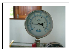
รูปที่ 34 เข็มของเกจวัดแรงดันแสดงการทำงานของเครื่องสูบน้ำดับ
